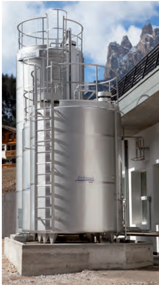
▲ Serbatoi di stoccaggio Storage tanks
